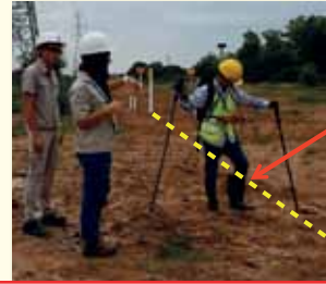
การตรวจสอบสภาพ Coating ด้วยวิธี DCVG
