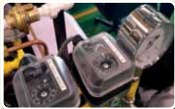
รูปที่ 2 Gas Pressure Switch และ Air Pressure Switch
