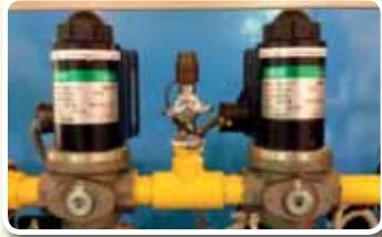
รูปที่ 1 Shut off Valve
