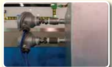
รูปที่ 5 Thermostat กำหนดค่าเป็น Temperature Control II: Over heat Protection
