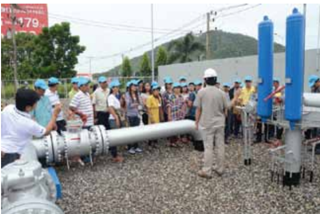
ชมสถานีควบคุมความดัน
